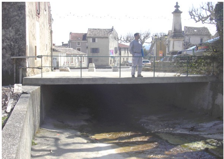
Cette photo représente l'ouvrage amont de la combe Boutin qui traverse le village de St Maurice sur Eygues, cet ouvrage a été submergé en 1992 et en 2002.
