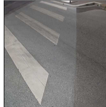
53- Revêtement granuleux appliqué en débord du passage piétons
