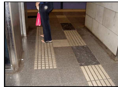
97- Barcelone – Dalle de grès damier en simple rangée devant l'ascenseur
