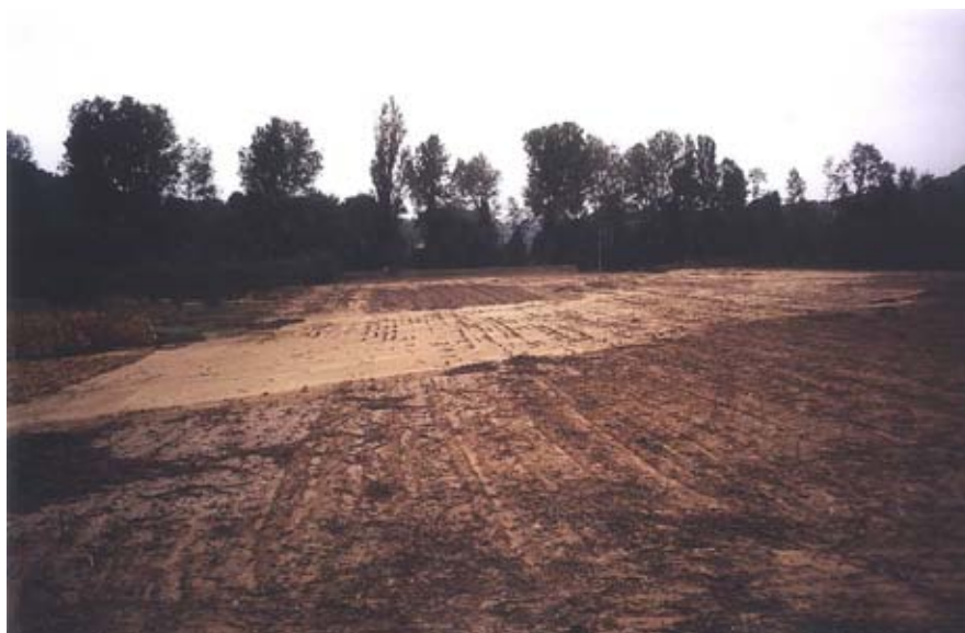
Brèche dans la levée de terre rive gauche au niveau des Guilhomonts
