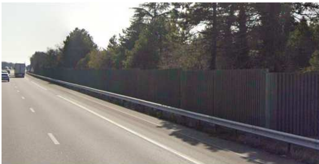
Ecran acoustique autoroute A7 K 103 (source photo Vinci Autoroutes)
