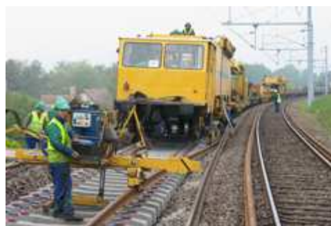
Longs Rails soudés sur traverses béton
