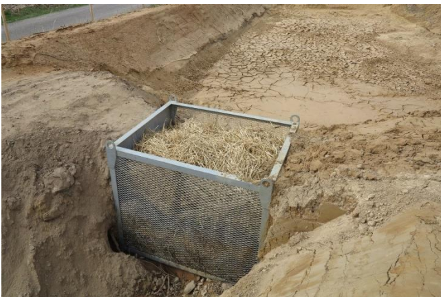
Exemple de bassin de rétention/filtration équipé d'un filtre à paille. ECOTER, 2016.
