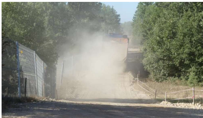
Exemple de levée de poussières lors du passage d'un camion : à éviter
