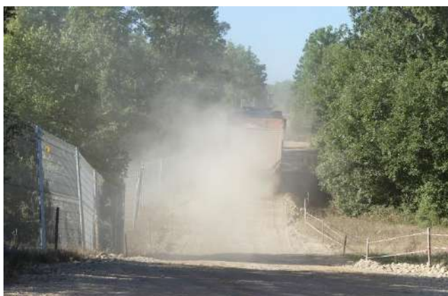
Exemple de levée de poussières lors du passage d'un camion : à éviter
