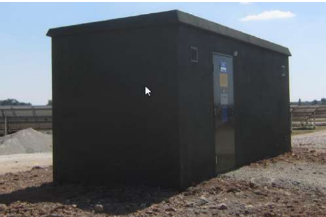
Exemple de poste de conversion « indoor »
