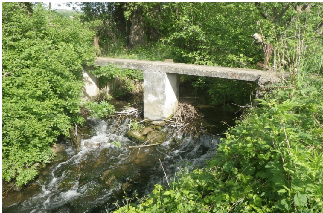
Figure 73 : Seuil de la vanne des Marelles, aval secteur 1, chute de 0.7 m à effacer.
