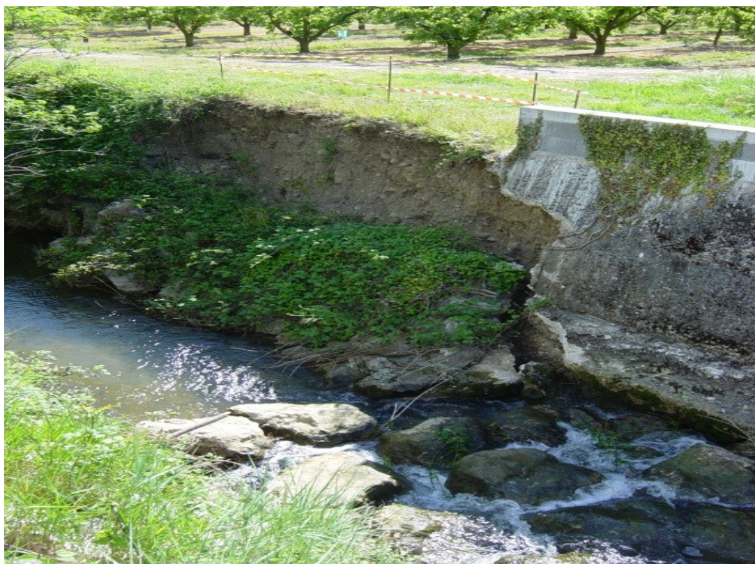
Figure 72 : Instabilité des berges et le déchaussement des ouvrages à Curson
