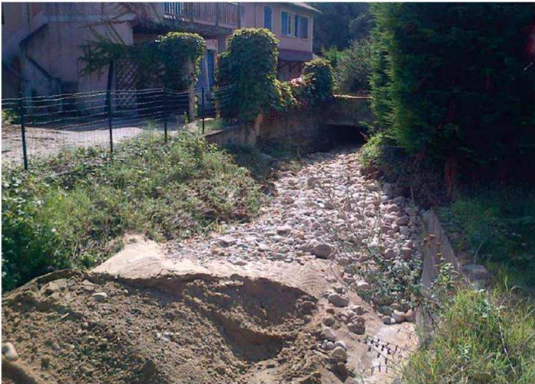
Fig. 101. Matériaux charriés et déposés sur le tronçon aval du Dravey suite à la pluie du 19 Septembre 2014.
