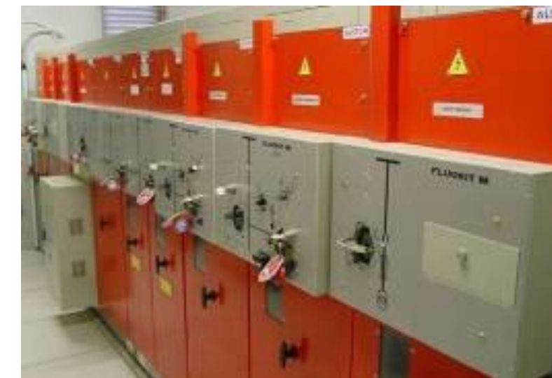
Photographie 37 : Cellules électriques du poste de livraison (source : CNR)
