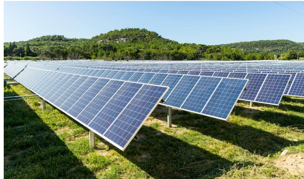
Figure 23 : Illustration des tables photovoltaïques (Saint-Restitut, Drôme)
