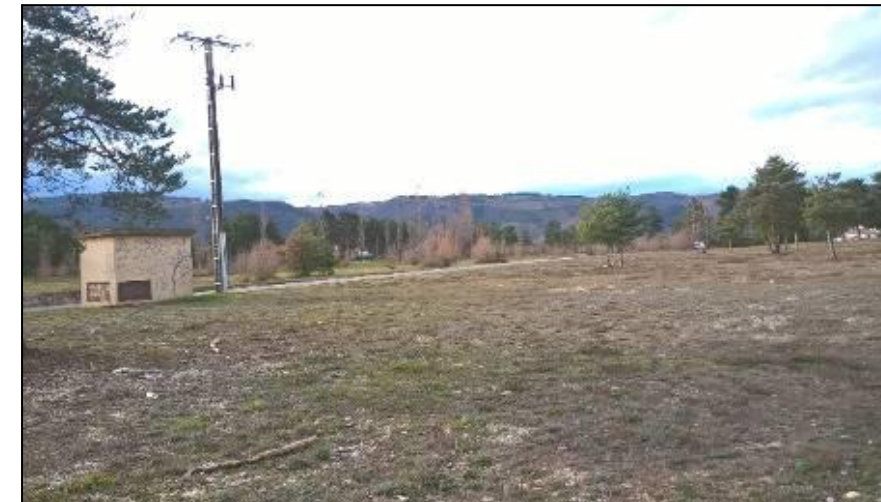
Photographie 12 : Transformateur inclus dans le secteur d'étude
