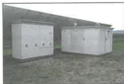
Poste transformateur « out-door » (parc photovoltaïque existant, Montéléger 1) Source : ARTIFEX
