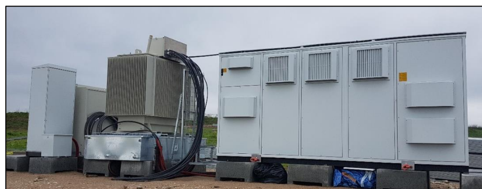
Exemple d'onduleurs et transformateur installés à l'extérieur Source : RES
