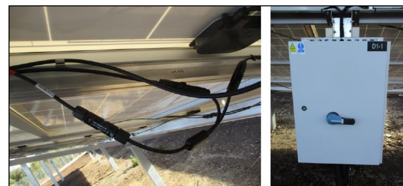
Exemple de câble électrique et de boîte de raccordement – RES Source : RES
