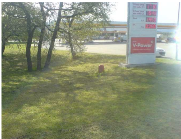
Poteau incendie aire est -face station service VL
