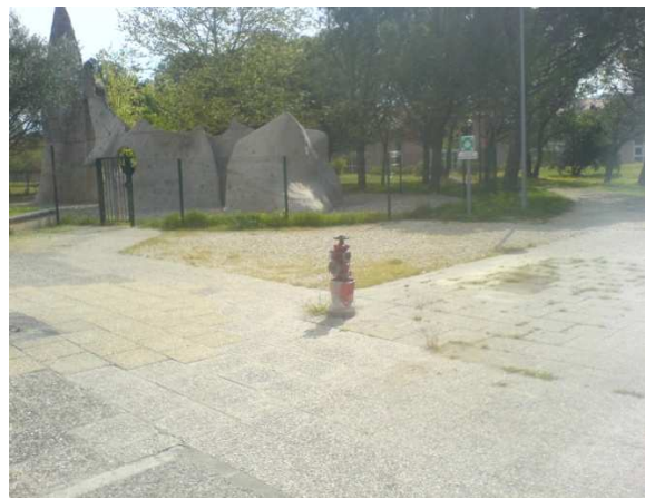
Poteau incendie aire est- sud de Mc donald's
