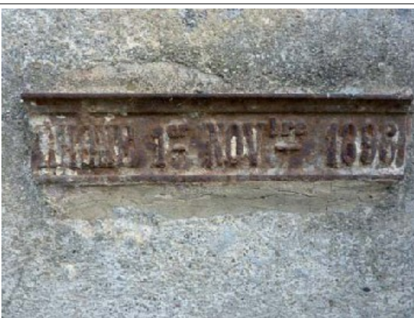
1er novembre 1896 - barre métallique – mauvais état
