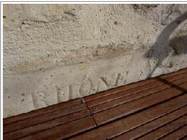
Repère n°1 : quartier de la Tête Noire, sur mur de la ferme des Roches – plaque de pierre gravée – bon état
